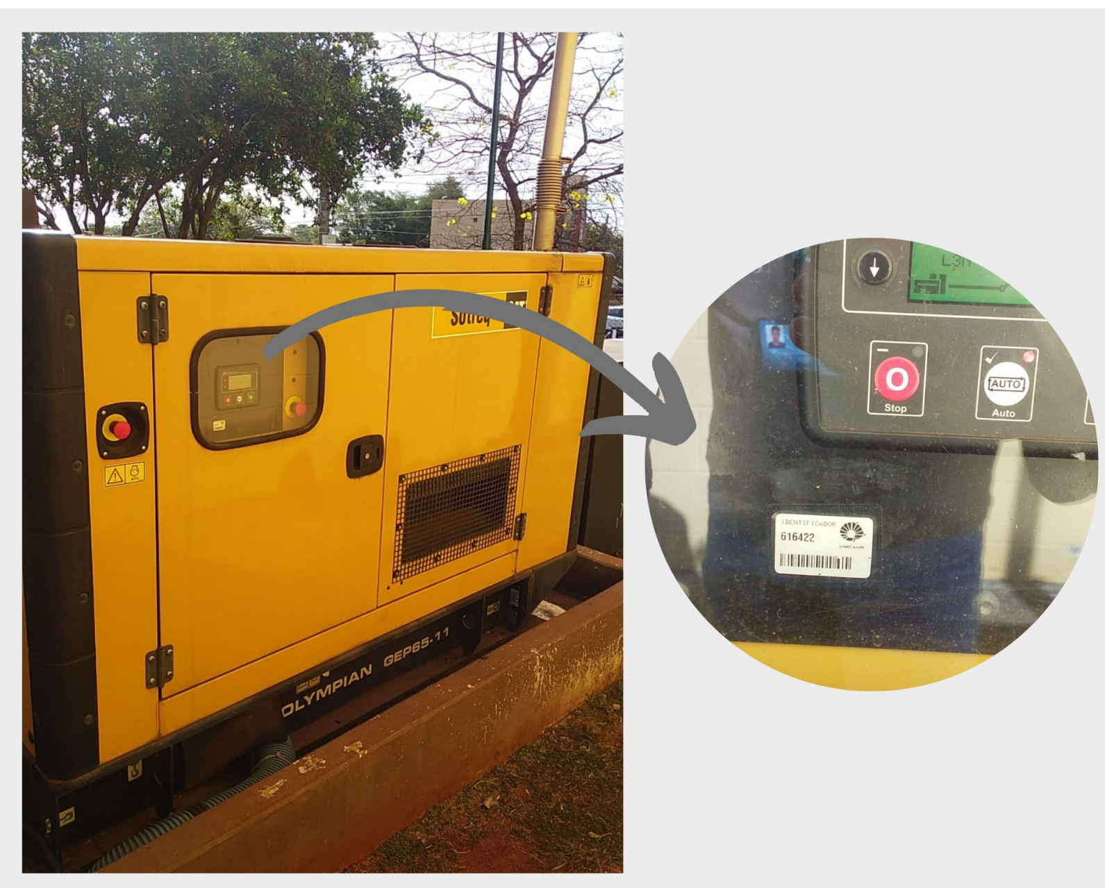
Grupo Gerador com Etiqueta de Identificação de fácil acesso
