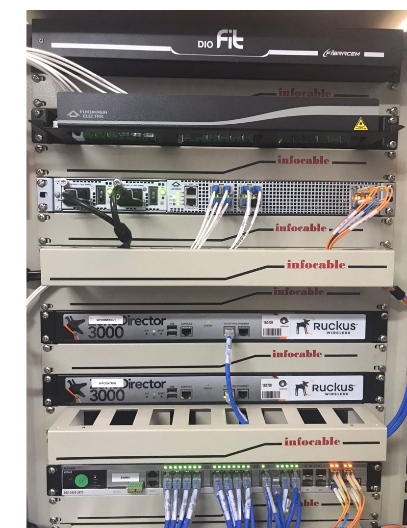
Rack Central com Terminais de Linha Óptica (OLT)
