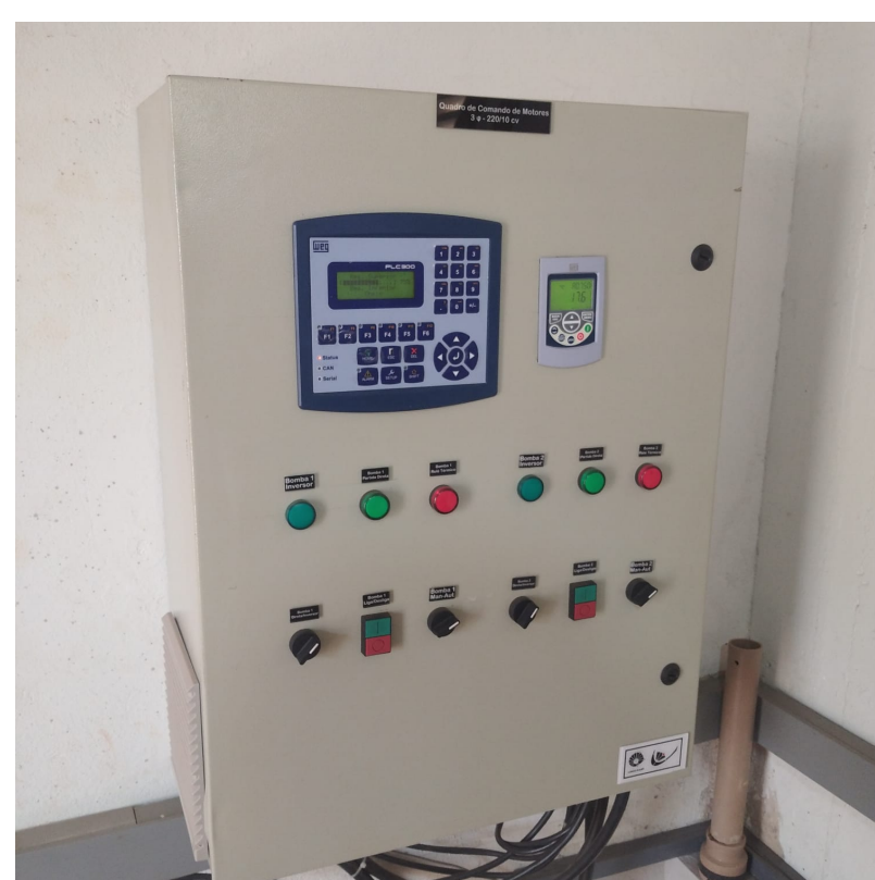
Vista Externa do Quadro de Automação
